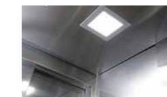
Iluminação eficiente e desligamento automático
